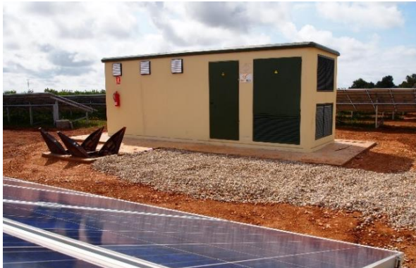
Installation de Cortadeta: bâtiment des onduleurs avec trois onduleurs centraux de 330 kW
