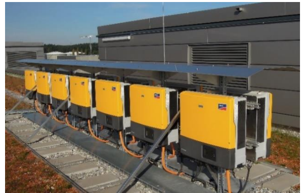
Installation de Pistor: onduleurs string avec une puissance de 17 kW
