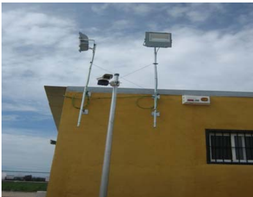
Les instruments de surveillance du parc solaire El Tesoro.
