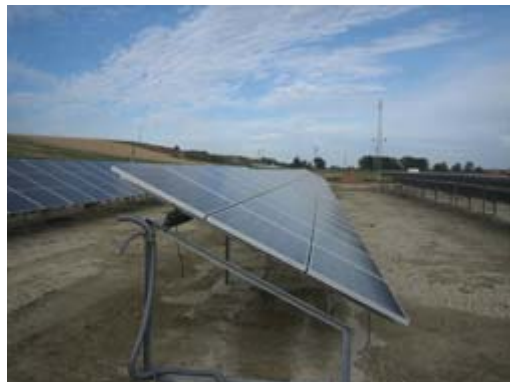
Alignement des modules du parc solaire El Trujillo.
