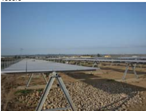
Warten auf die Hauptsicherungen: El Tesoro
