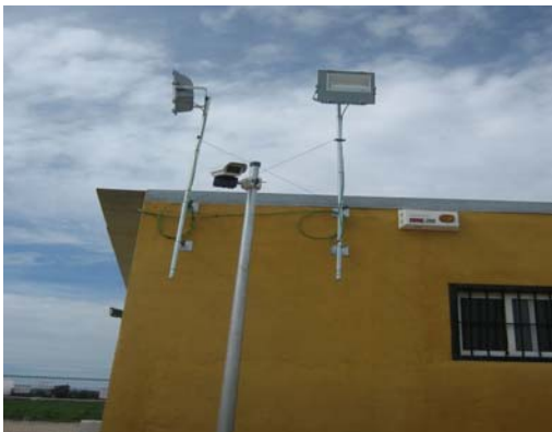
Die Überwachungstechnik des Solarparks El Tesoro
