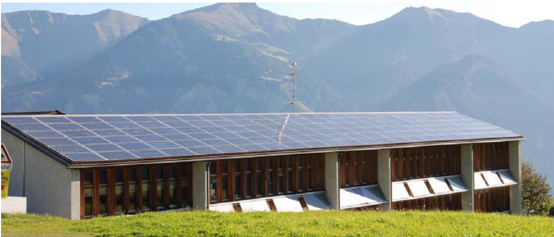
Ecole de Flerden – un bon exemple d'une installation intégrée au toit
