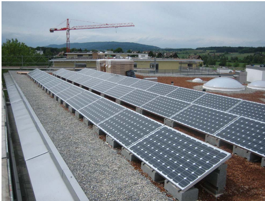
Anlage "Wolfswinkel" auf Minergie-Bauten der Allgemeinen Baugenossenschaft Zürich ABZ
