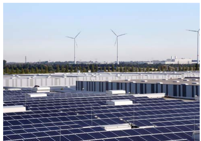
3'608 kWp-Anlage Alter Flughafen Leipzig
